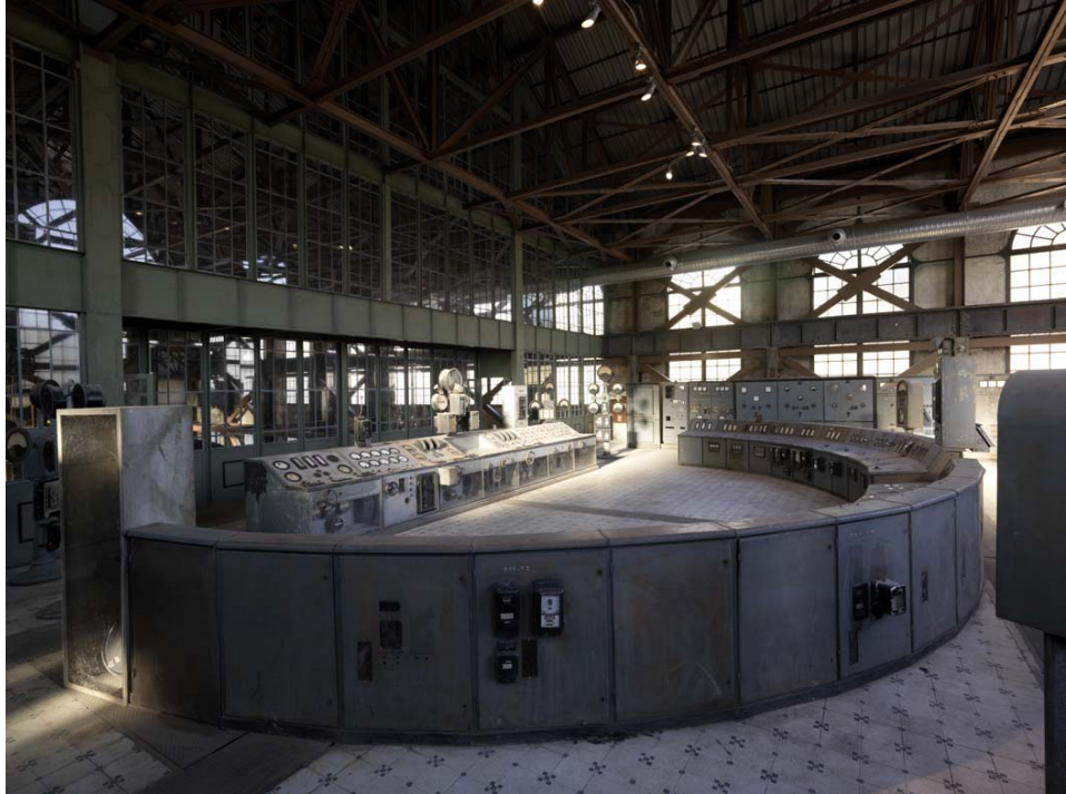
Şekil 6.10 : Kontrol odası genel görünüş (B. Kaşlı arşivi).
