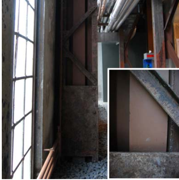
Şekil 6.8 : 1 numaralı makine dairesi zemin katında kolonda çelik güçlendirme (B. Kaşlı arşivi).
